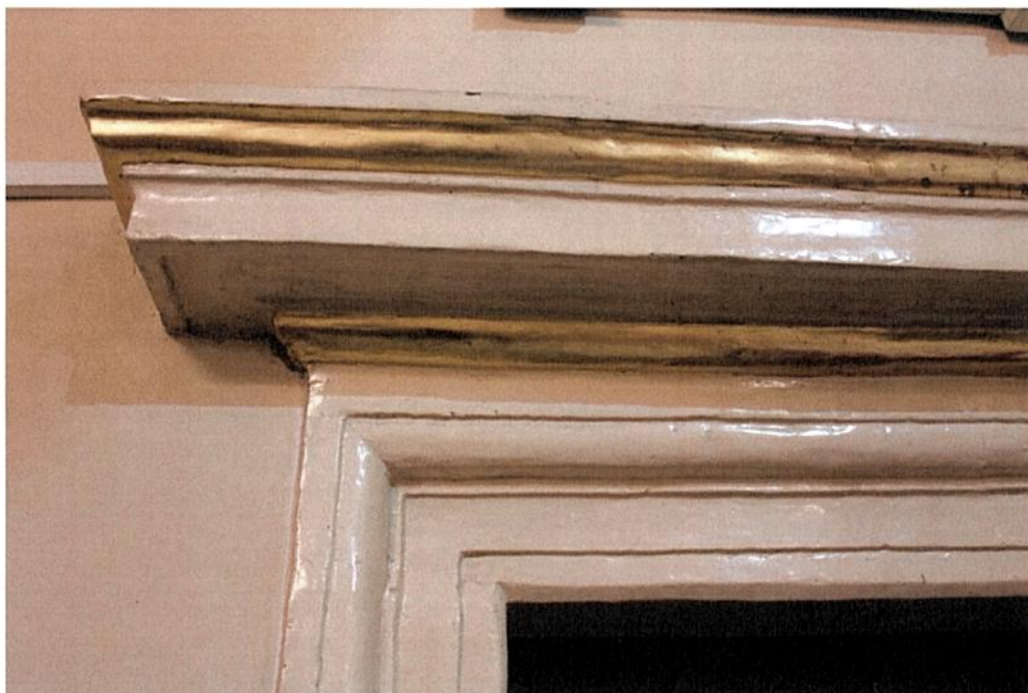
Fot 4. Portal – fragment nadproża. Zniszczenia powstałe na skutek przemalowań kamienia farbą olejną.
