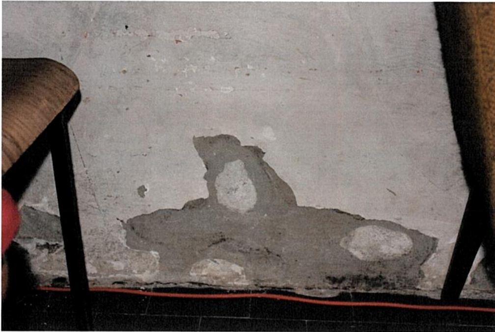
Fot. 2 Nawa główna, zawilgocenie i odpadanie tynków.
