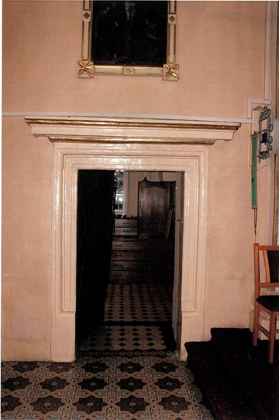
Fot. 7. Tuczepy. Kościół p.w. św. Jana Chrzciciela. Kamienny portal w przejściu z prezbiterium do zakrystii. Widoczny bardzo zły stan zachowania piaskowca spowodowane przemalowaniami farbą olejną.
