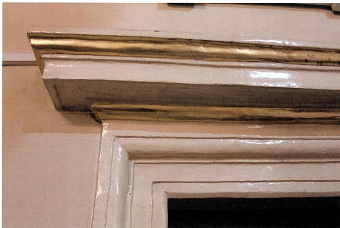
Fot.10.Tuczepy. Kościół p.w. św. Jana Chrzciciela. Kamienny portal w przejściu z prezbiterium do zakrystii. Widoczny bardzo zły stan zachowania piaskowca spowodowane przemalowaniami farbą olejną.
