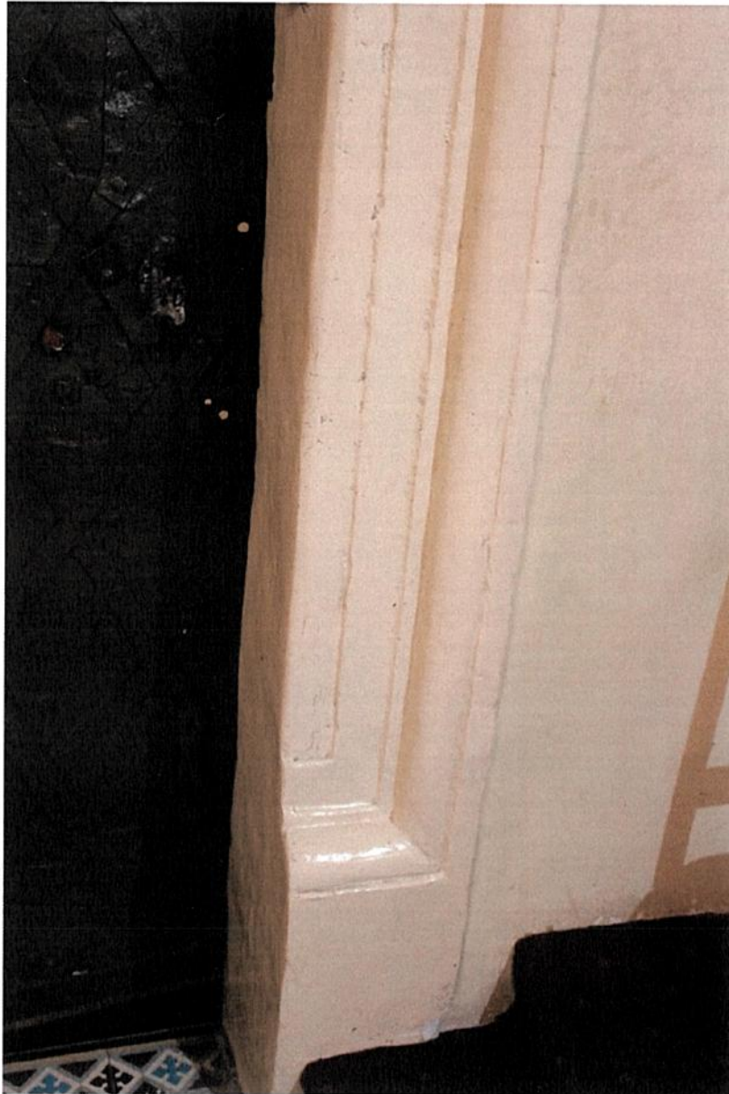
Fot.11.Tuczepy. Kościół p.w. św. Jana Chrzciciela. Kamienny portal w przejściu z prezbiterium do zakrystii. Widoczny bardzo zły stan zachowania piaskowca spowodowane przemalowaniami farbą olejną.
