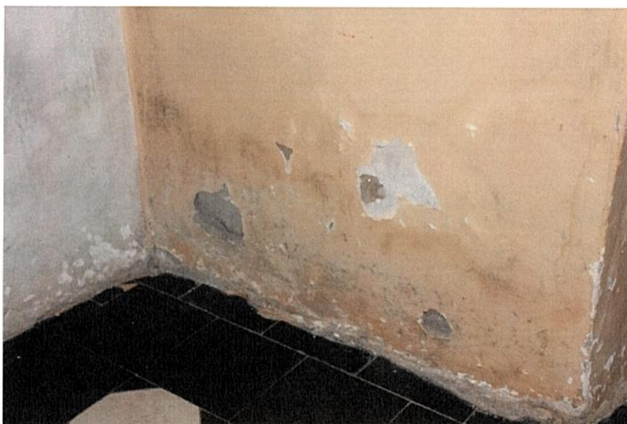
Fot. 1. Nawa główna, ściana północna pod chórem. Widoczne zawilgocenie i odpadanie tynku w miejscu przyziemia.
