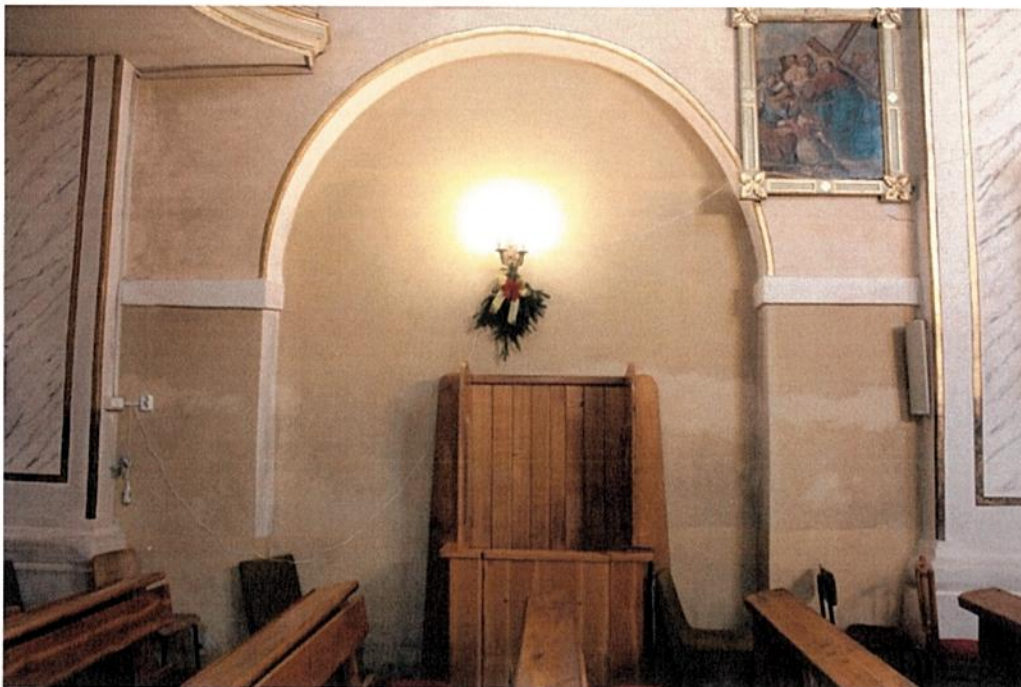
Fot. 3 Nawa główna, ściana północna pod chórem. Widoczne przebarwienia kolorystyczne monochromii.
