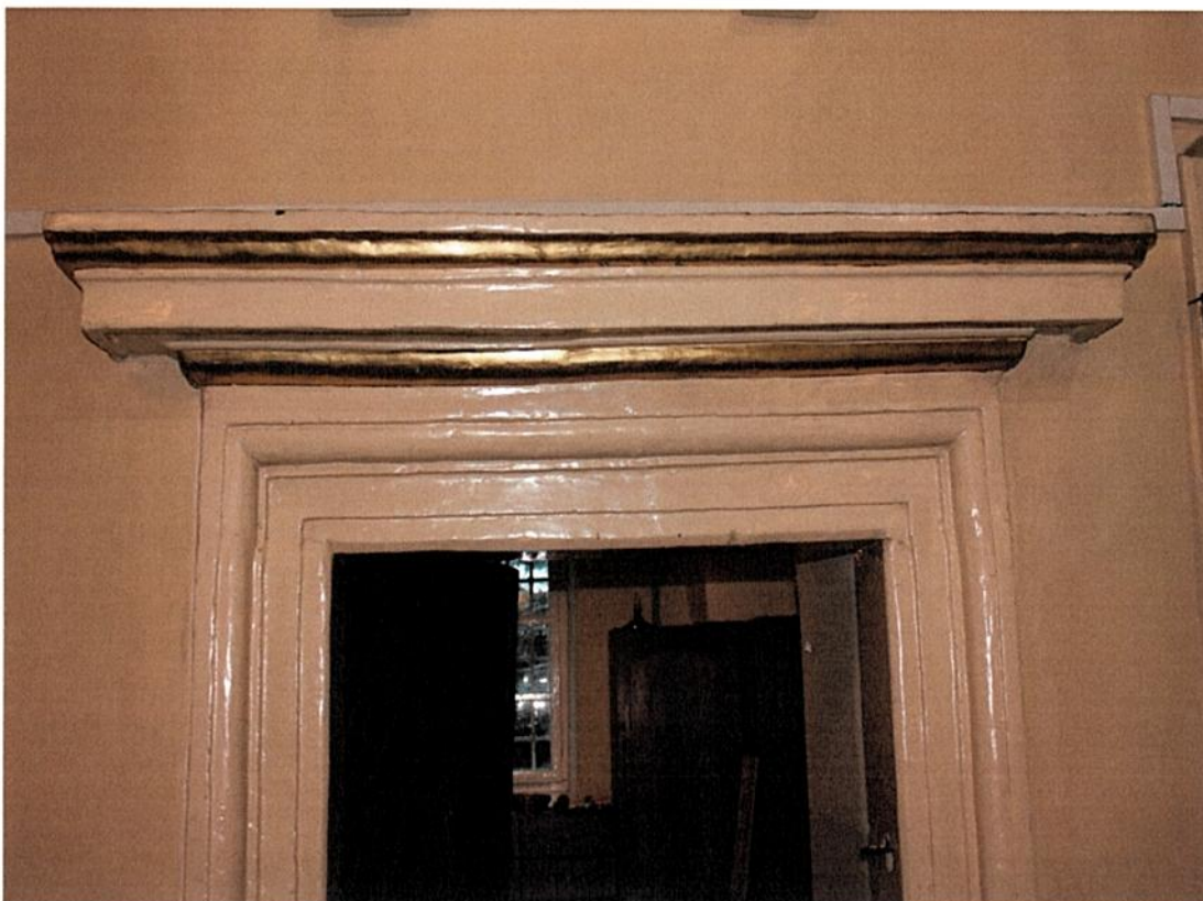
Fot. 9. Tuczepy. Kościół p.w. św. Jana Chrzciciela. Kamienny portal w przejściu z prezbiterium do zakrystii. Widoczny bardzo zły stan zachowania piaskowca spowodowane przemalowaniami farbą olejną.
