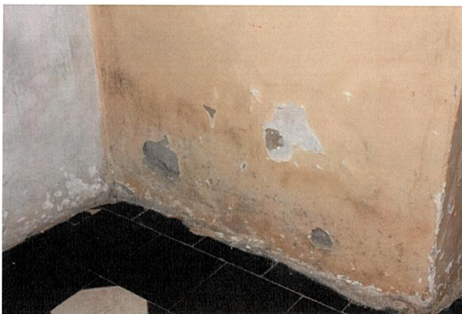
Fot. 1. Nawa główna, ściana północna pod chórem. Widoczne zawilgoconie i odpadanie tynku w miejscu przyziemia.
