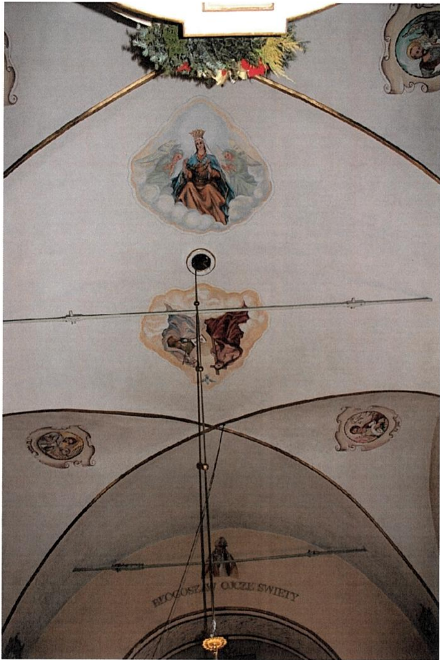
Fot. 4. Tuczepy. Kościół p.w. Św. Jana Chrzciciela. Nawa główna, widok sklepienia. Widoczna polichromia wnętrza kościoła z 2002 r. ze scenami figuralnymi („Trójca Święta”, „Królowa Polski”, Ewangelisci). 2024 r.
